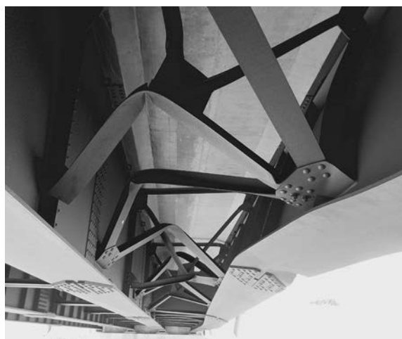
雪崩による出逢橋橋桁損傷状況
