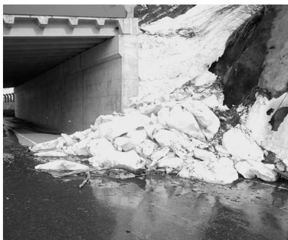
苧巻第2ロックシェッドの雪崩
