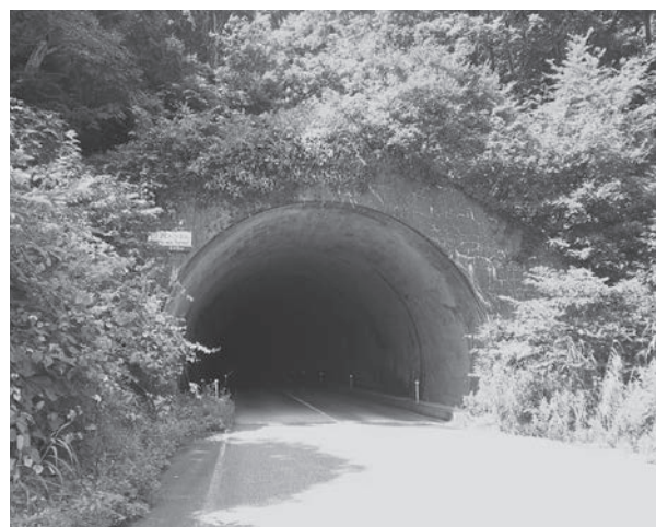
照明のない白沢トンネル
