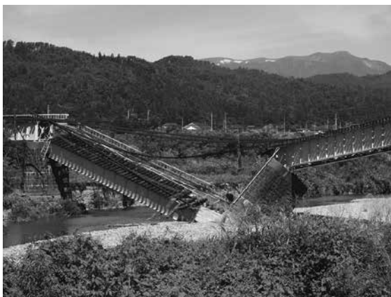
倒壊した濁川橋梁
