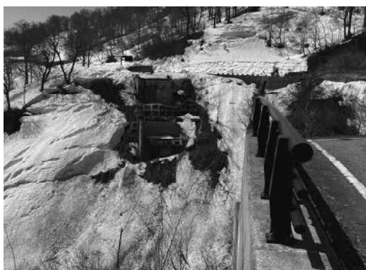
あいよし橋流失後の様子
