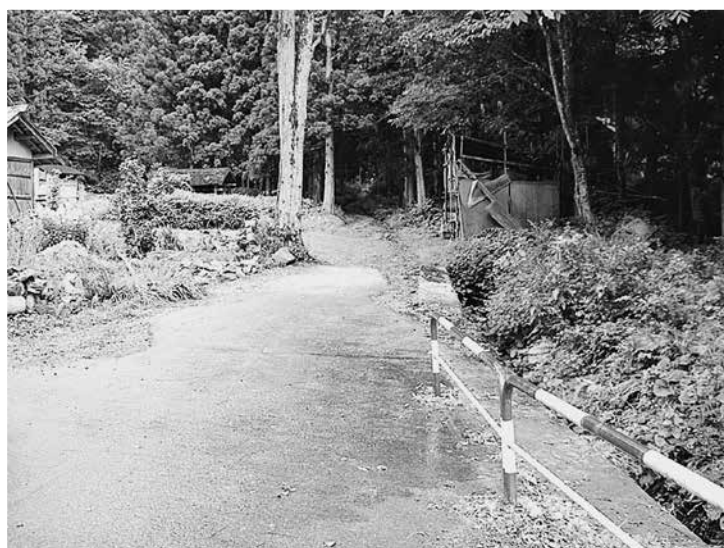
会津美里町東尾岐地内先から未整備・交通不能
