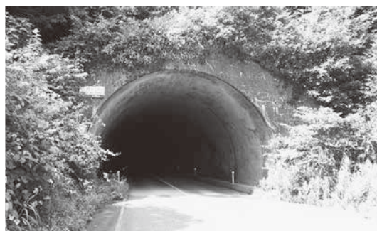
「照明のない白沢トンネル」
